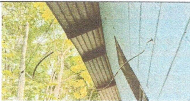
Foto 3: se observa la necesidad de sustituir el cable de alimentación principal, se ve que sufrió corto circuito
