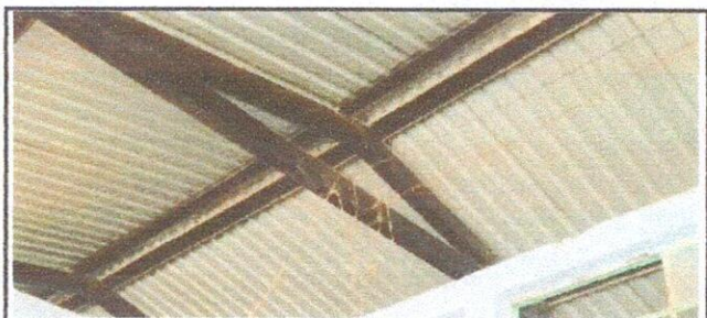
Foto 4: se observa la necesidad de sustituir los cables en todos los módulos
